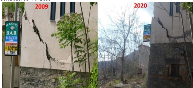
Fig. 8 – Due foto dello stesso edificio nell'area maggiormente danneggiata a distanza di 10 anni
