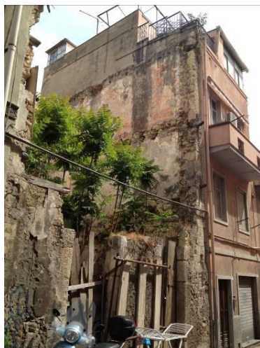
Fig. 2 – Un crollo storico in via Piccioni
